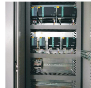
电气控制柜装配工艺标准样品
