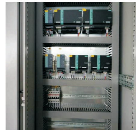
电气控制柜装配工艺标准样品
